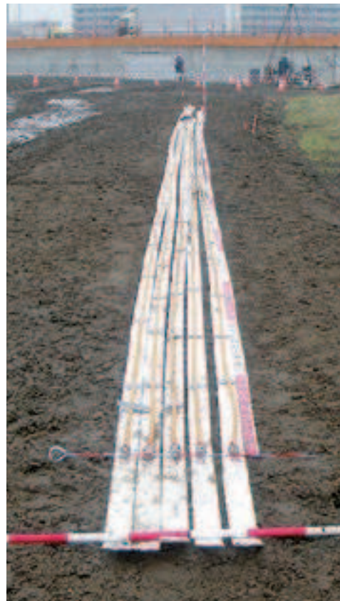
計測装置(例)：間隙水圧計 (地中の間隙水圧を計測し、真空圧の作用) 状況を確認)
