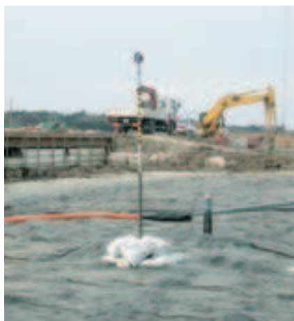
計測装置(例)：沈下板 (地表面沈下を計測)
