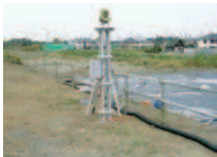
自動計測装置(例) (地表面沈下、変位を計測)
